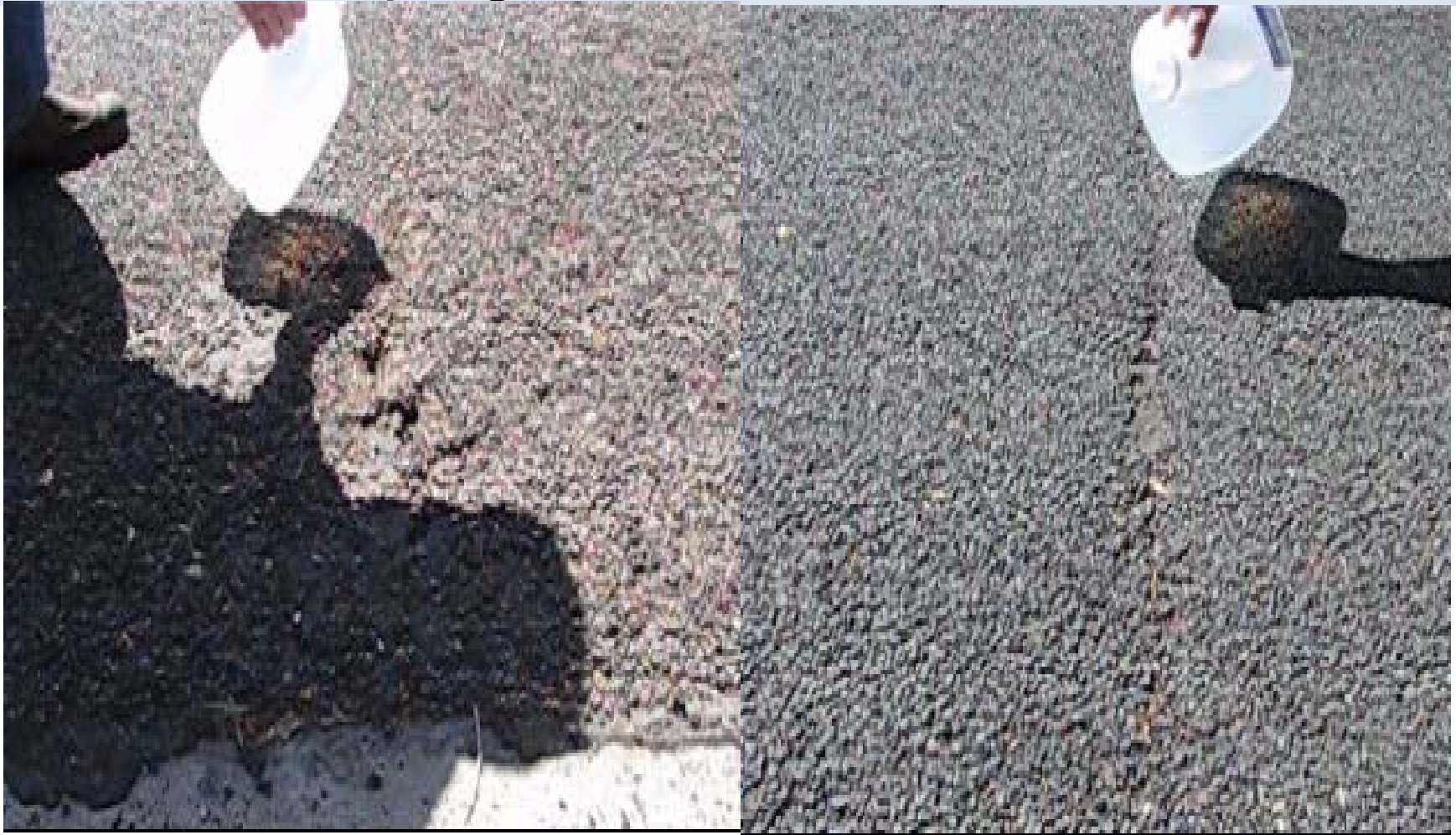
No Moisture Barrier
