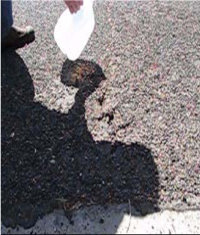
No Moisture Barrier
